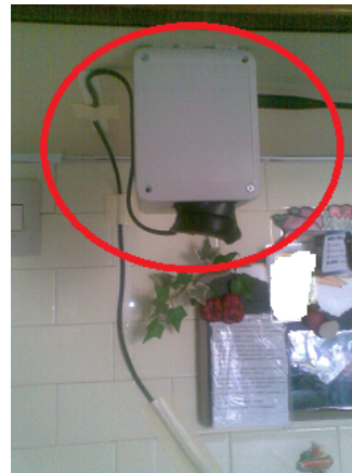
(d) Passive infrared presence sensor over the kitchen table
